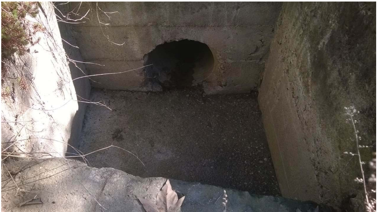
Foto 5. Pou de recollida aigües cuneta Autopista.
