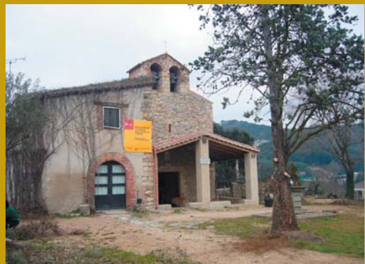
La intervenció ha permès restaurar les condicions de seguretat i estabilitat de l'Església de Sant Llorenç.
