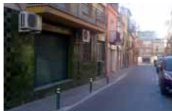
Instal·lació de pilones al carrer Sant Pere per garantir una circulació més segura de vianants i vehicles
